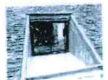
CREVEE DE TOITURE
