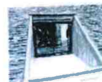
CREVEE DE TOITURE
