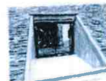
CREVEE DE TOITURE
