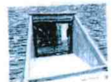
CREVEE DE TOITURE
